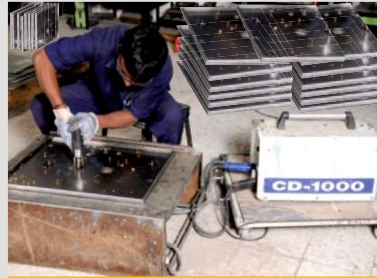
Stud & MIG-MAG Welding
